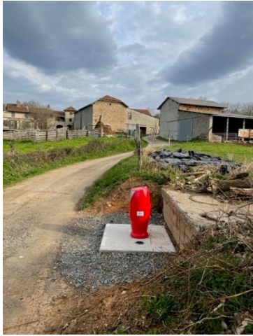
Ci-dessus : le poteau incendie pour le Feyt.
